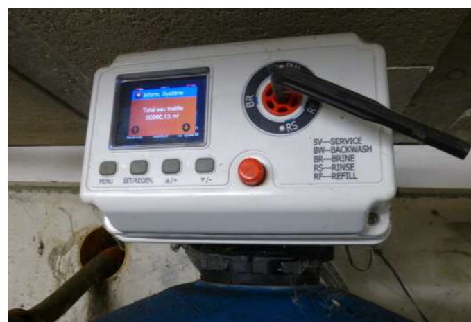
Exemple de compteur comptabilisant les eaux traitées
