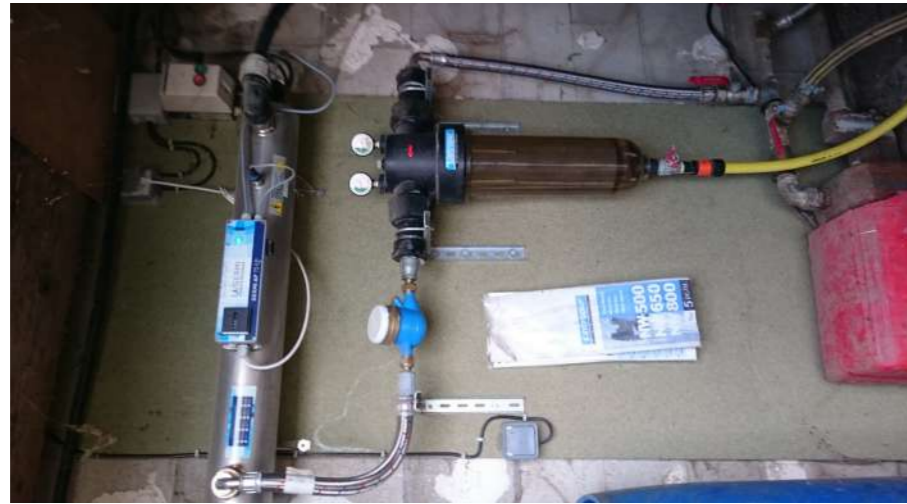
Exemple d'installation de traitement de l'eau avec lampe UV chez un éleveur de Haute Saône (BFC)
