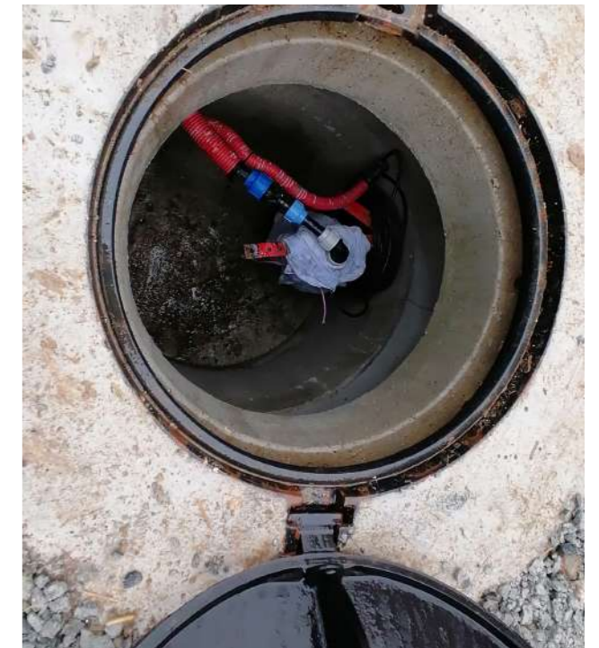
Regard de forage
