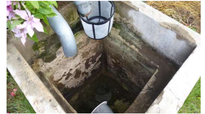
Panier dégrilleur avant entrée dans la citerne
