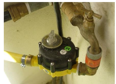
Mini-compteur d'eau Chambre d'Agriculture France
